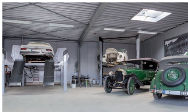
In der Werkstatt sorgt die Industriebodenheizung aus vorgefertigten Registern für räumliche Freiheit und ein gesundes Arbeitsklima.
