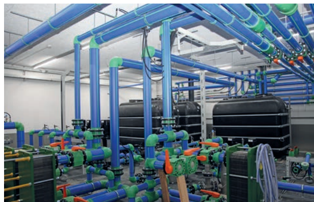
Im Bereich des Prozesswassers wurde aquatherm blue pipe verbaut.
